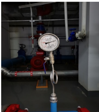
图2 消防水泵吸水管上安装的真空压力表
